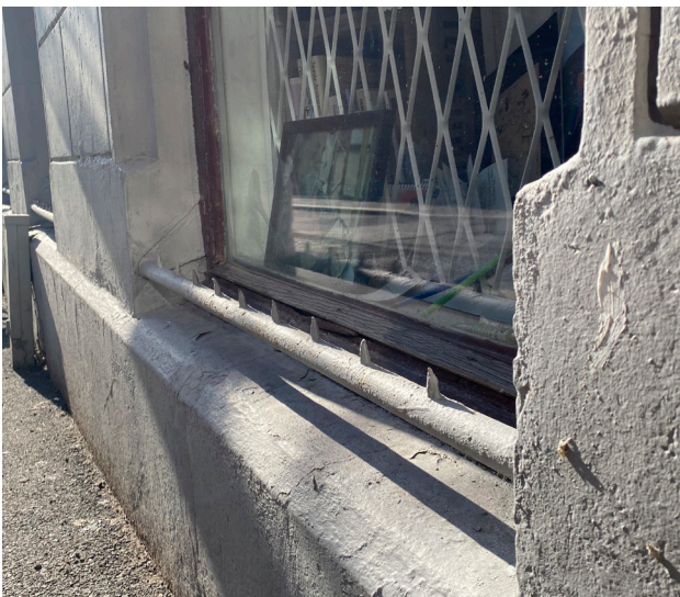
Hvor: Akersveien Hva: Metallpigger i vinduskarm
