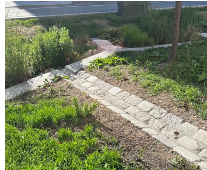
Fig. 30: Dårlig vekst og slitasje på plen langs regnbedets vannrenner.
