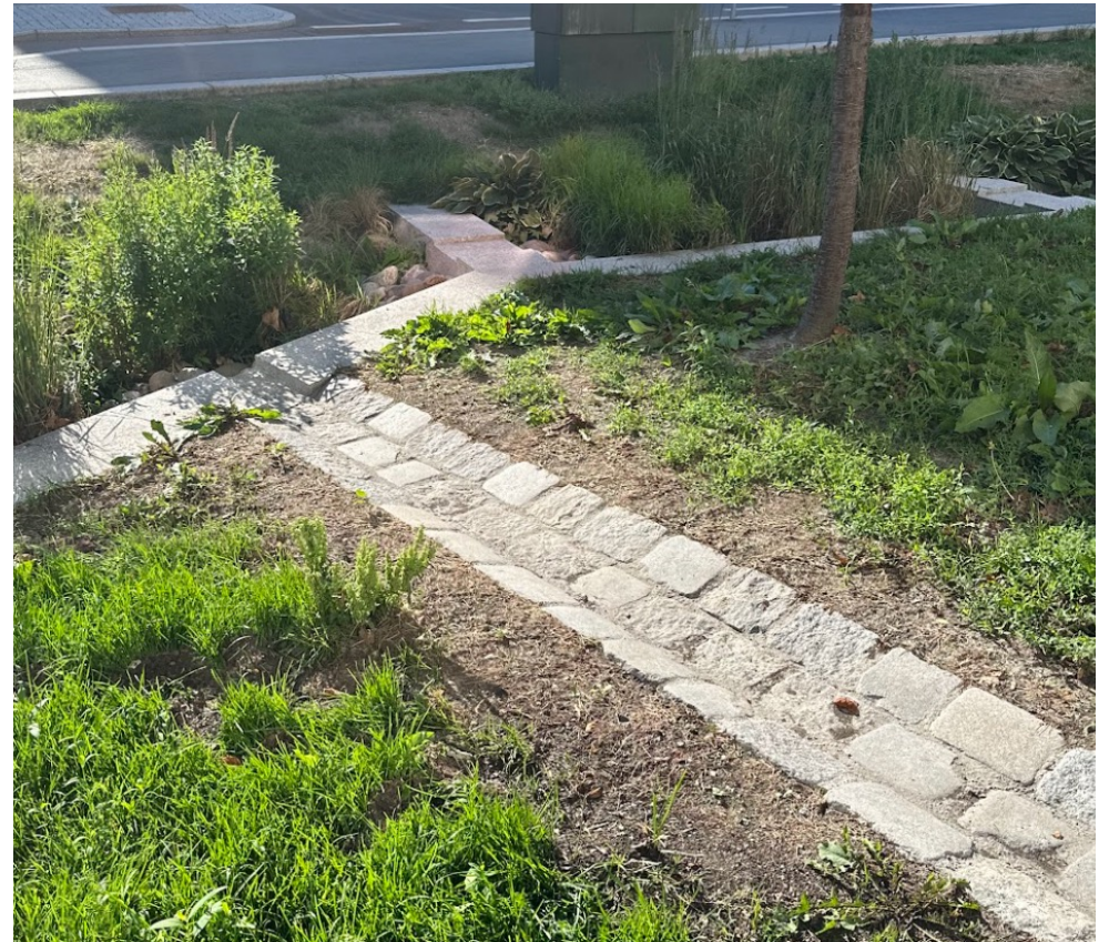
Fig. 64: Slitasje på siden av den samme rennen tyder på underdimensjonering.
