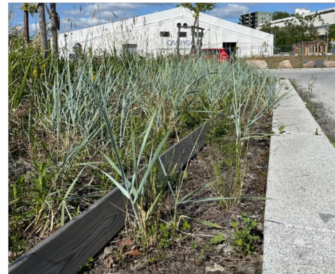
Fig 22: Gjerdet rundt anlegget har falt sammen og det er stort sett dårlig vekst i kantene.
