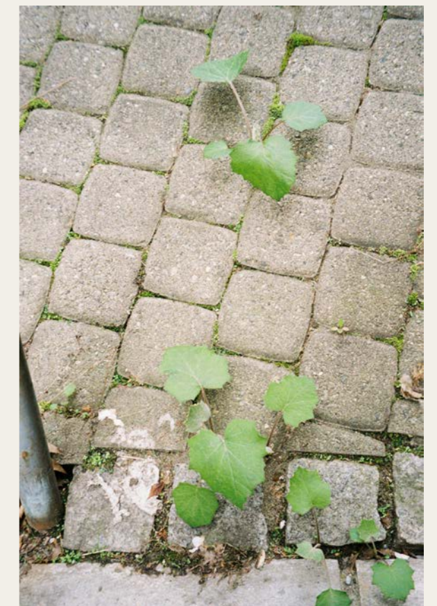
Vegetasjon som vokser opp fra belegget i rampen
