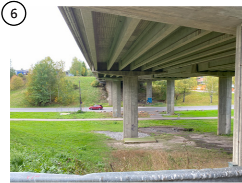
6 Området under brua til Fossumveien er svært utstelt. D10 ses ved siden av bilvei.
