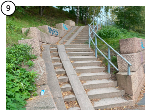
9 Raskeste forbindelse videre langs turveien er ned denne trappa. Nærmeste universelle forbindelse er en god omvei.
