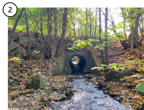
2 Bekken legges flere steder i kulverter under turveien på denne måten.
