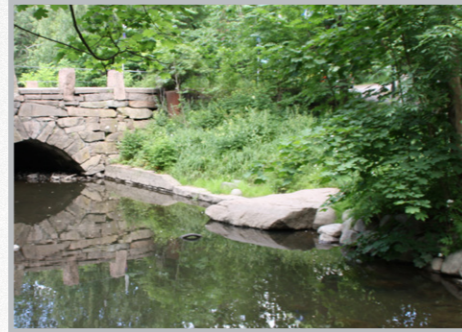
Stein er lagt ut for å gi tilgang til Alnaelva ved Kalbakken bru.
