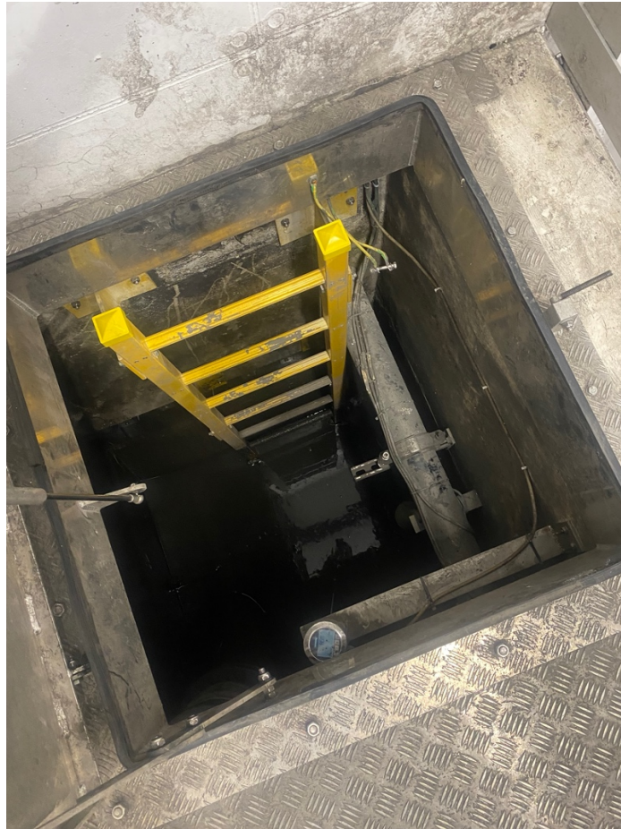
Figur 3: Pumpesumpen hvor tunnelvaskevannet samles før det blir pumpet videre til sedimenteringsbasseng. Mye blir allerede sedimentert i pumpesumpen.
