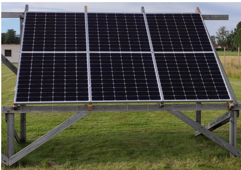
Figur 4.2: Oppsett av solcellemoduler på Søråsjordet. Det er 3 moduler som er koblet sammen til en felles inverter.
