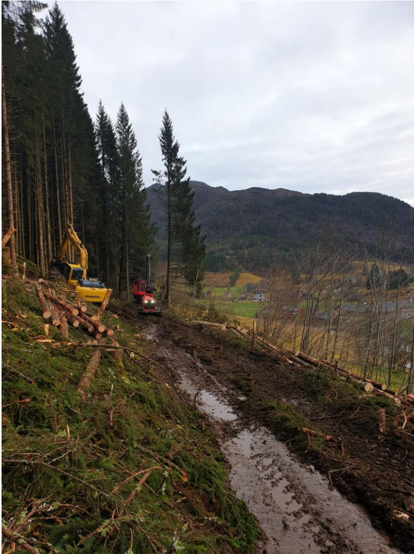
Figur 4: Gravedrifter kan gjøre stor skade på skogbunnen og føre til erosjonsfare om man ikke fjerner veiene etter driften er ferdig, på bildet ser vi hogstmaskinen kjøre inn i et område der graver har gravd frem en vei, mens graver går opp og starter på en ny driftsvei. Foto: Audun With Aasgård
