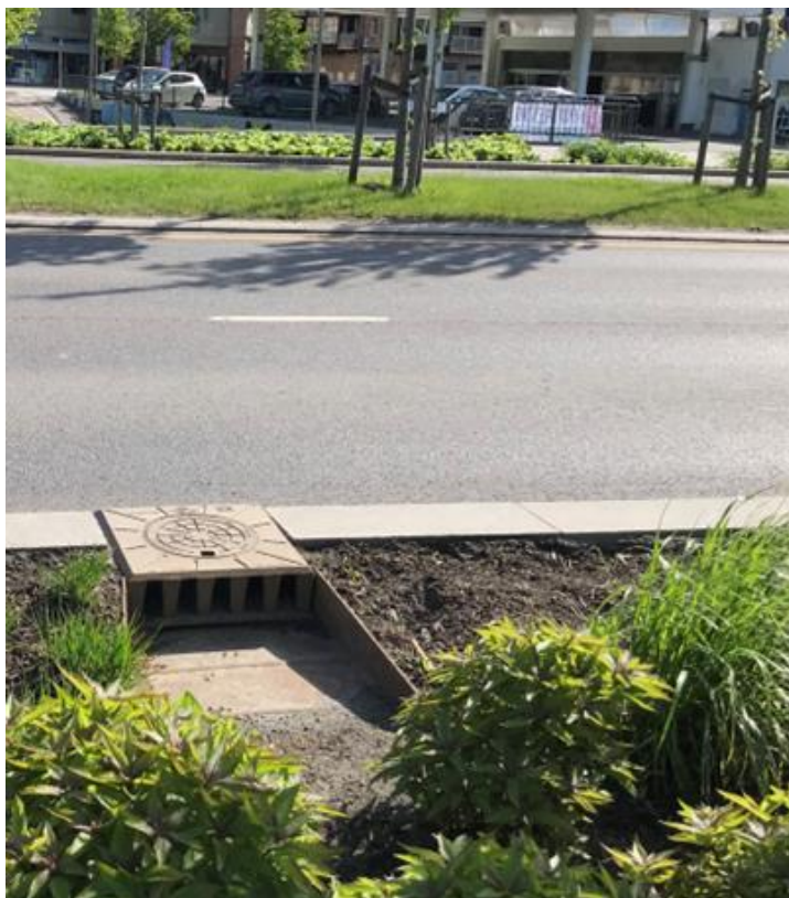
Figur 18: Bildet viser hvordan regnvann fra gata samles og renner ut i regnbedet via «kjeftsluk». Foto: Katinka Horgen Evensen.
