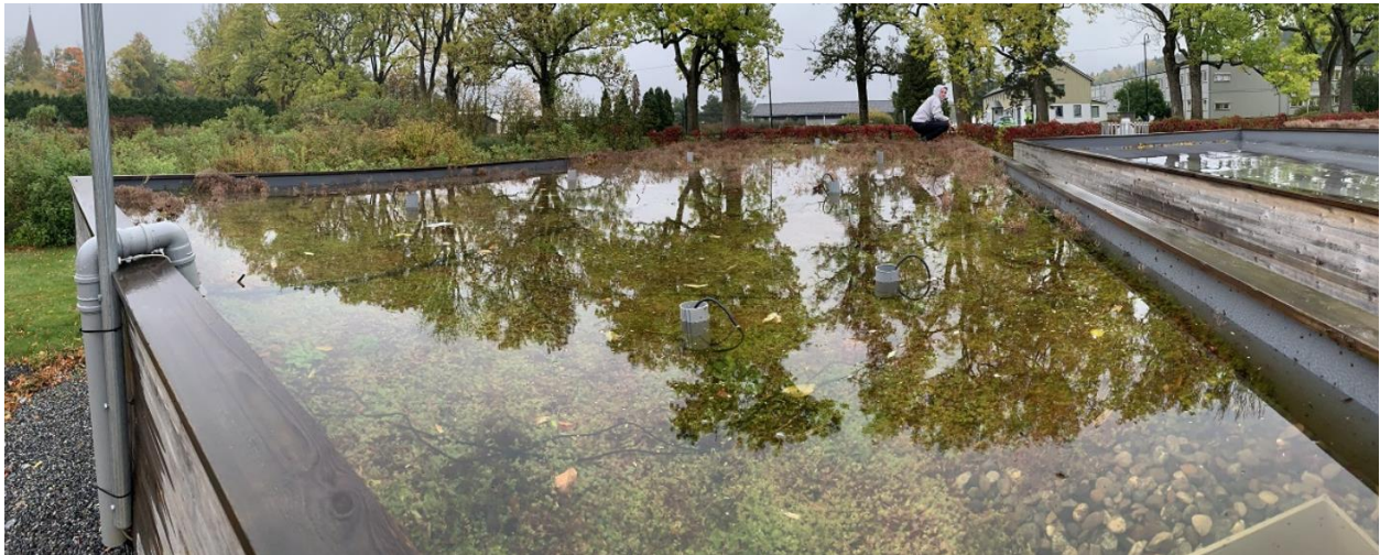
Figur 7: Fritt vannspeil ved fylling. Foto: Peter Andreas Bassøe (2020). Figur hentet fra Bassøe (2020).
