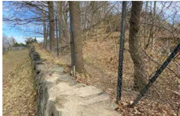
Figur 64: Hull i gjerdet mellom gravplassen og Micheletfjellet
