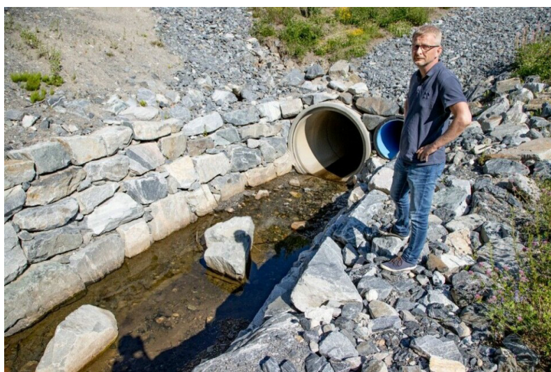
Figur 31: I utformingen av et nytt løp for Sellikbekken ble det brukt kulvert. Tiltaket er preget av ensidig fokus på tilpasning til klimaendringene med negativ effekt for natur og økosystemtjenester. Høyre mur og store rør er et særdeles dårlig tiltak fordi vannføringen vil få mye større hastighet enn om det var brukt vegetering. (Skancke, 2021)
