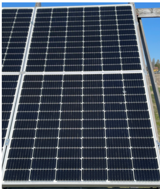
FIGURE 4.17: Visuell inspeksjon av Bi2. Bildet viser ingen synlige skader, bare skit og støv på modulen.
