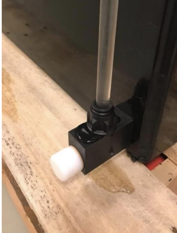
Figur 12: Bilde av lekkasje fra monteringspunkt til stigerøret.
