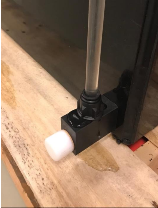
Figur 33: Bilde av lekkasje fra monteringspunkt til stigerøret.
