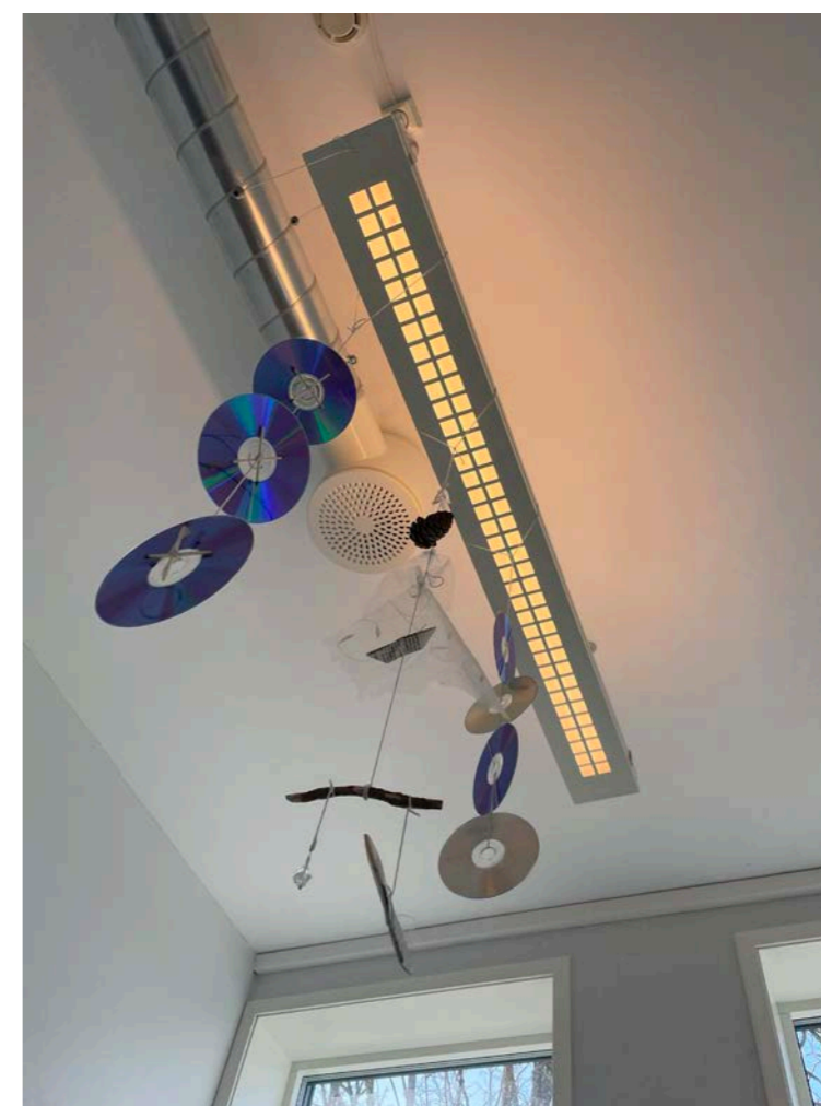
Figur 1.5: Installasjoner på kontoret
