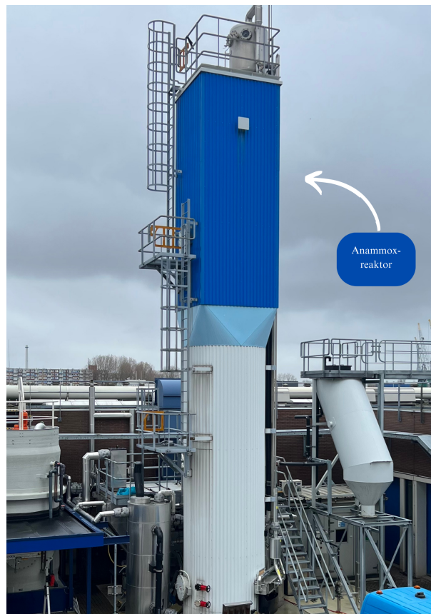
Figur 4.6: Anammox-reaktor på Slujesjesjik slambehandlingsanlegg i Rotterdam. Fotograf: Charlotte Marie Trovaag, 14.03.23.
