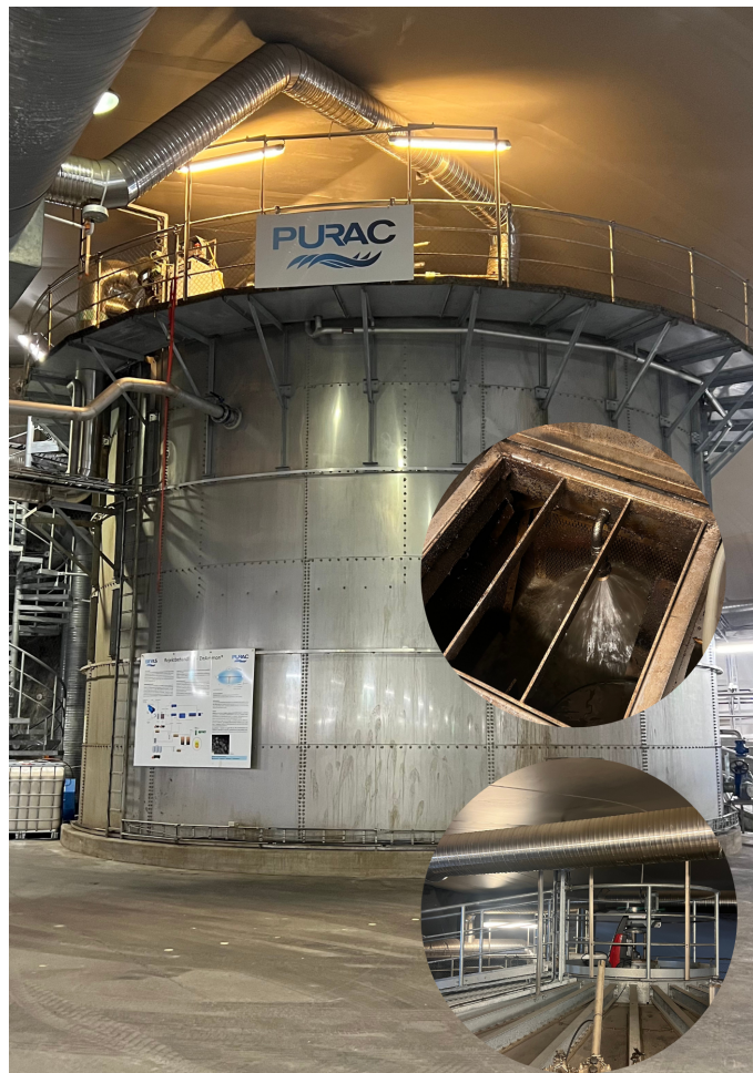
Figur 4.4: Bilder fra befaring på Bekkelaget renseanlegg. Bildene viser DeAmmon. Fotograf Charlotte Marie Trovaag, 190123.
