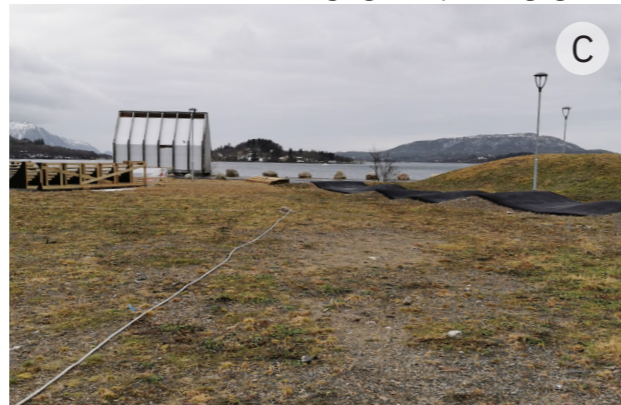
Figur 1.4: Bilde tatt mot vest, av skaterampe under bygging, oppmålt volleyballbane, sykkelsti og grillhytta
