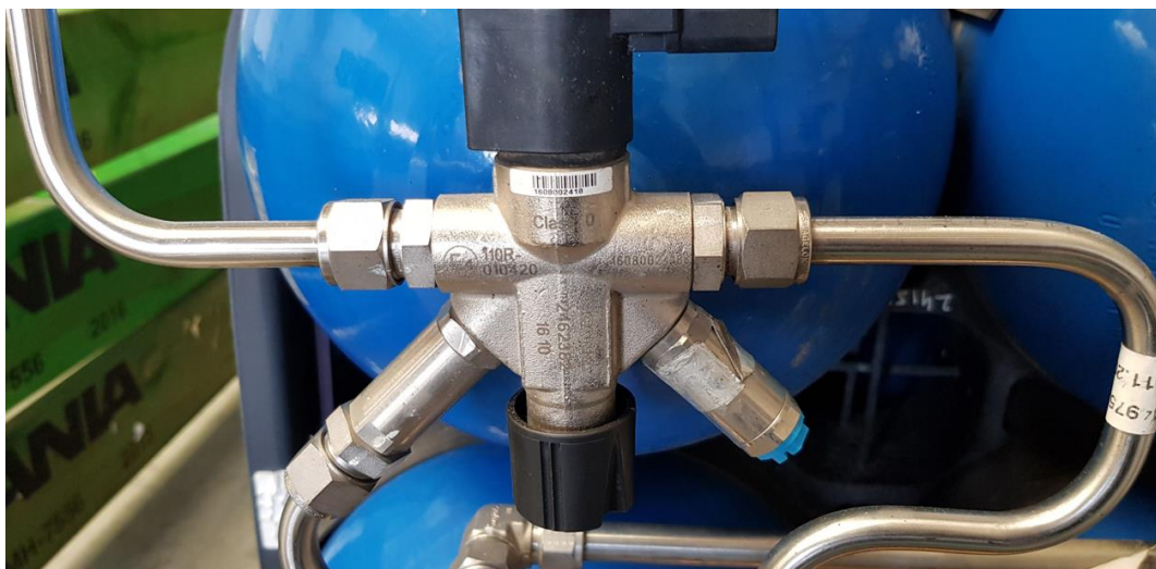
Figur 31: Bilde av ventilsettet på en CNG tank (Norsk Scania AS, 2023).
