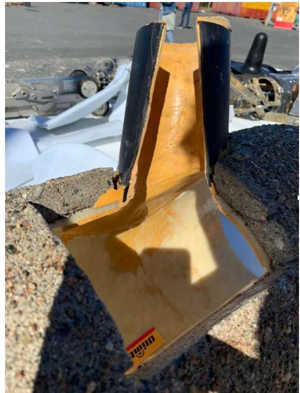
Figur 37: Strømperenovering av betongledning ved innhuggene rørrinnføringer. Bilde tatt under åpen dag hos Olimb AS.
