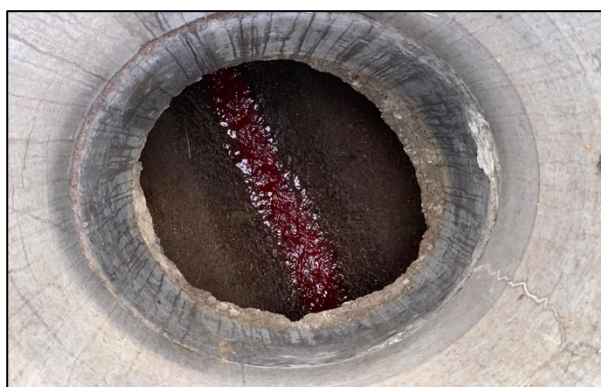
Figur 35: Fargeprøve for lokalisering. Foto tatt under befaring.
