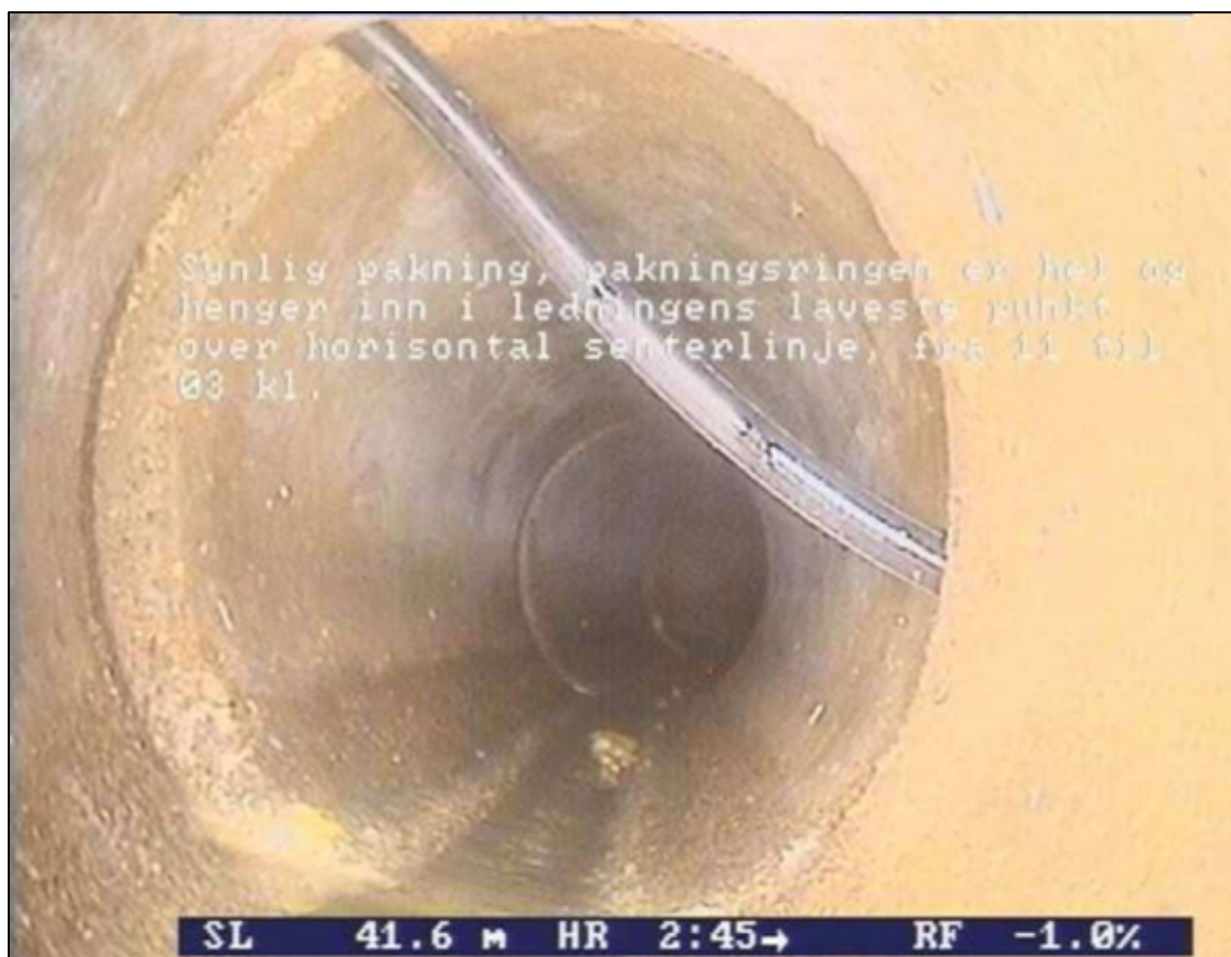
Figur 33: Utklipp fra rørinspeksjon der synlig pakning vises.
