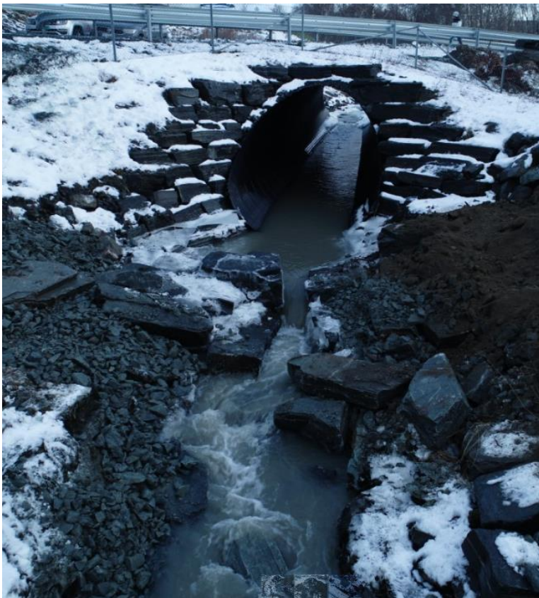
Figur 19. Bildet viser området etter at NVE utførte opprettingsarbeid, med fortsatt vanskelige forhold for fisk. NVE påpekte i ettertid at det bør konstrueres nytt elveløp (personlig kommunikasjon, NVE, 16. feb. 2023) (foto: Bane Nor)
