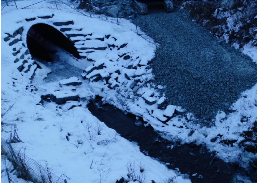
Figur 18. Bildet viser kulvert 2 etter at Bane Nor og entreprenør forsøkte å rette på utført tiltak, før NVE ble leid inn. Løsningen skapte et trangt løp med stort fall og høy vannhastighet fra konstruert terskel nedstrøms røret, laget for å heve vannstanden i røret (foto: Bane Nor)
