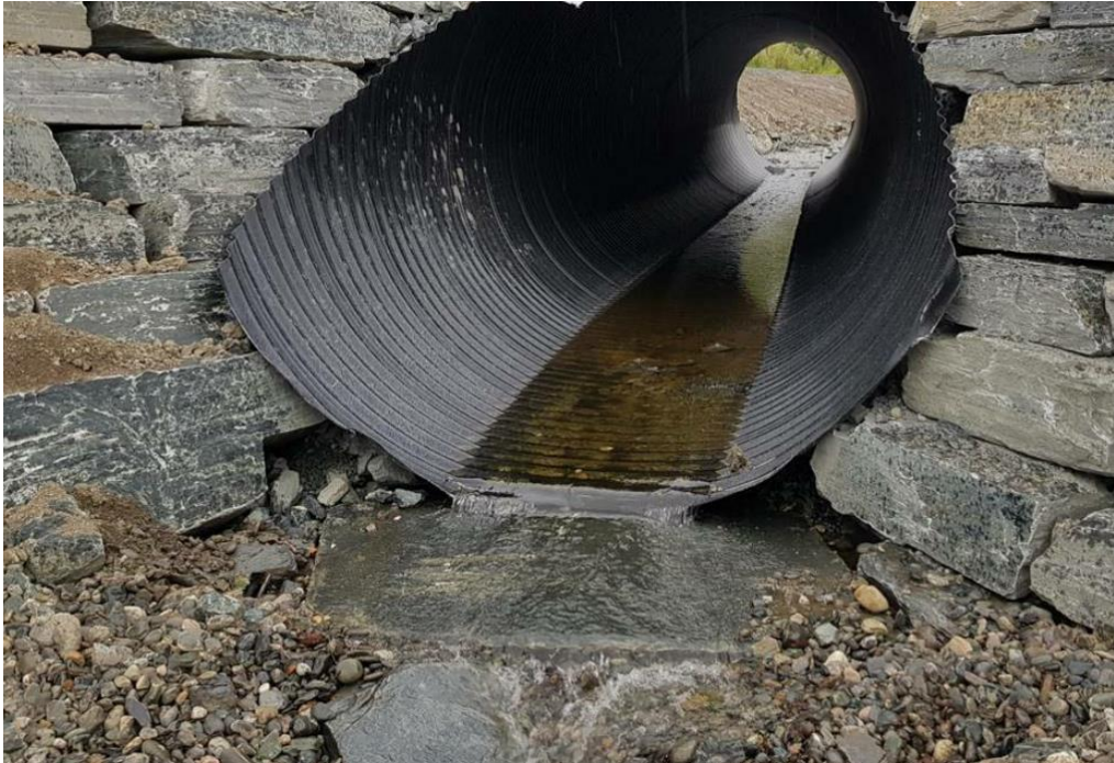
Figur 17. Kulvert 2 etter ferdigstilling, sett på lav vannføring. For høy plassering av rør med svært lav vannstand både gjennom røret og nedstrøms utløpet, samt uheldig steinhelle ved utløp. (foto: Stian Stensland).
