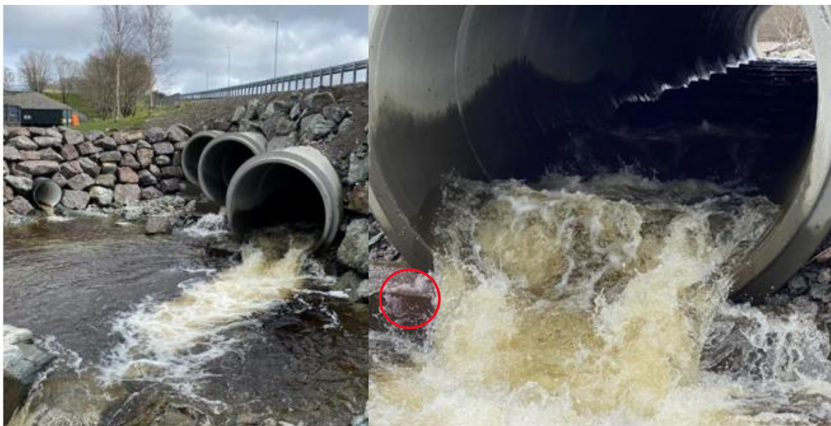
Figur 20. Kulvertløsningen i Botngårdselva. 3-rørs løsningen som ble valgt med et lavereliggende rør med terskler, og to overløpsrør for bedre kapasitet ved stor vannføring. Løsningen førte til stor vannhastighet og turbulens i røret, fall ved utløp og fare for skade på fisk pga. skarp betongkant rett under utløpet (rød ring) (Bergan et al., 2020).
