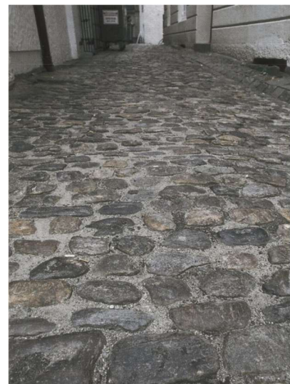
Figur 21: Kuppelsteinsdekket fra 1886 finnes fortsatt i smuget ved sørlige del av Vaskerelvsmauet. Foto: (Heldal et al., 2000, s. 146)
