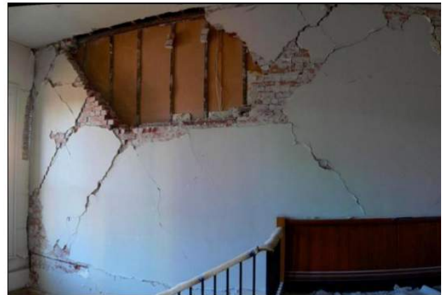
Figur 12 – Skader fra to-veis utbøyning ut av planet.
