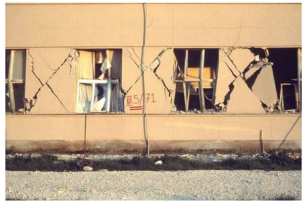
Figur 28 - Typisk skjærbrudd for avstivende veggelementer i murverk (Tomažević, 2008).
