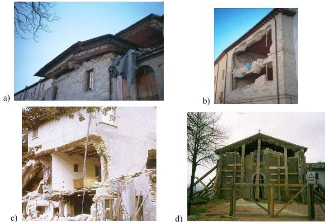
Figur 17 – Skader som følge av for stive gulvskiver etter jordskjelvet i Umbria-Marche (Italia) i 1997 (Brignola et al., 2008).
