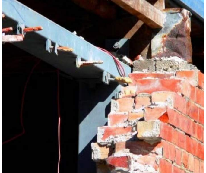
Figur 21 - Kollaps ut av planet, utilstrekkelig forankringslengde for limankere (Dizhur et al., 2013).
