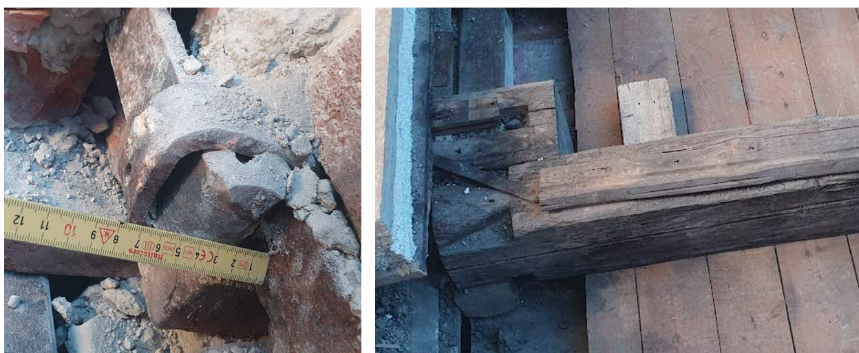
Figur 8 – Til venstre ser vi en forbindelse (nål) i langankeret. Til høyre ser vi forbindelsen der bjelkelaget er koblet over hjerteveggen for å sikre fastholdning mot strekkrefter (egne bilder).
