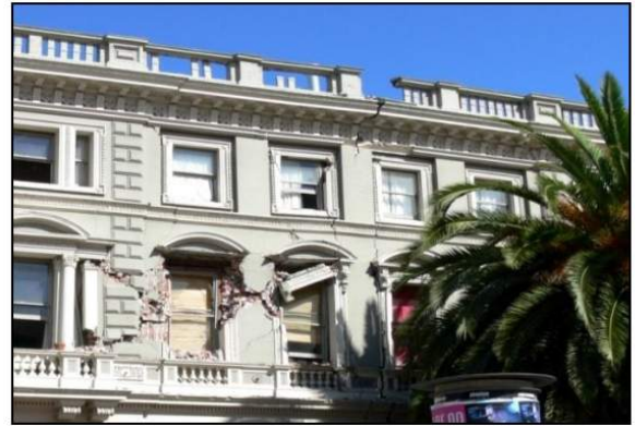
Figur 26 - Diagonale skjærbrudd gjennom søyler og overdekninger (Dizhur et al., 2011).
