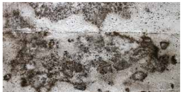
Fuktgjennomtrengning i takflaten
