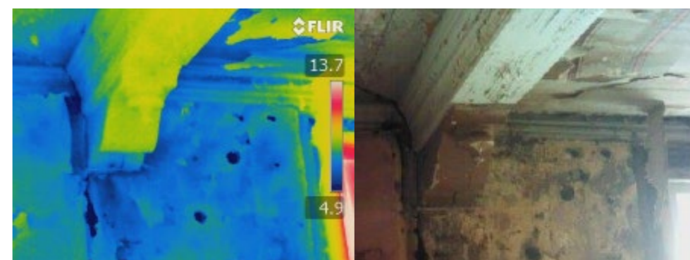
Figur 3.25. Skader i tømmerkonstruksjonen. Termografert av Torstein Hagen, 2022.
