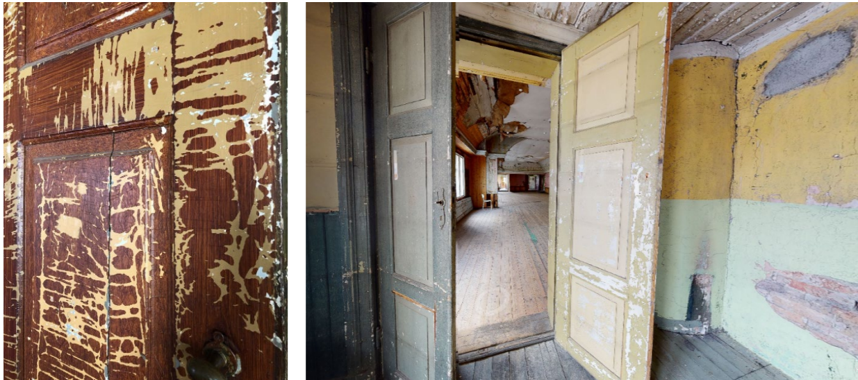
Figur 3.11-3.12. Dørene i andre etasje har tydelig slitasje fra flere år med manglende vedlikehold. Hovedsakelig er det snakk om slitasje på overflaten, men flere av dørene har sprekker og andre skader på selve trevirket. Egenproduser bilde.
