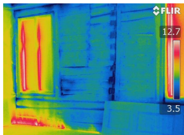
Figur 5.2. Termografering av Konservativen. Foto: Torstein Hagen 2022.
