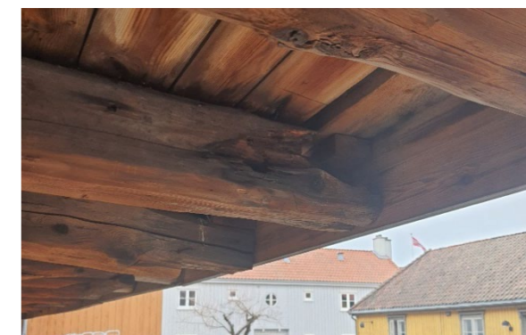
Figur 5.4. Råteskade i bjelke. Egenprodusert bilde.
