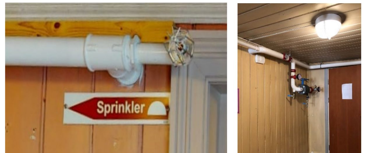
Figur 3.16-3.17. Sprinkleranlegg i Konservativen. For å sikre brannsikkerhet ble det montert sprinkleranlegg i første etasje, som ligger nedenfor himling. Sprinkleranlegget er meget synlig og virker inngripende i de kulturhistoriske detaljene. Egenprodusert bilde.
