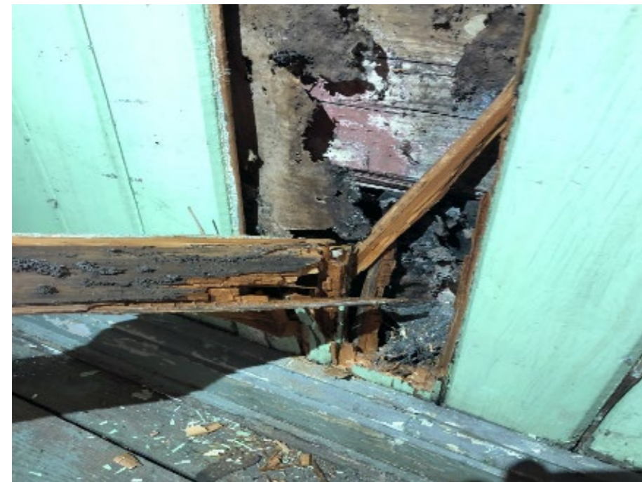
Figur 3.19. Hussopp. Flere av ytterveggene har råte og muggsopp voksende i tømmerkonstruksjonen. Hentet fra Bygningsantikvariske undersøkelser, 2019.
