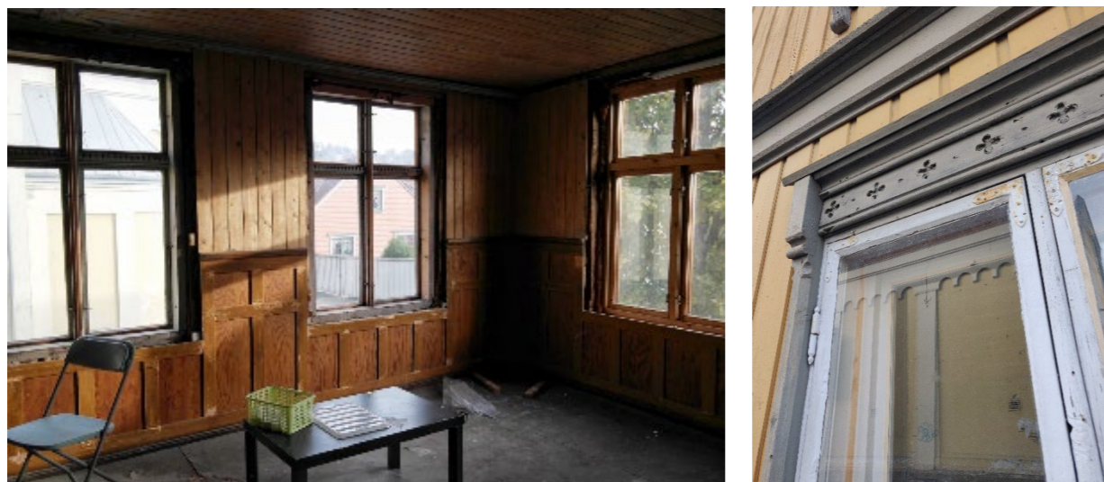
Figur 3.12-3.13. Vinduene i Konservativen. Bygget har en blanding av originale vinduer fra tidlig 1900-tallet og nyere vinduer. Flere av vinduene har fukt- og råteskader. Egenprodusert bilde.
