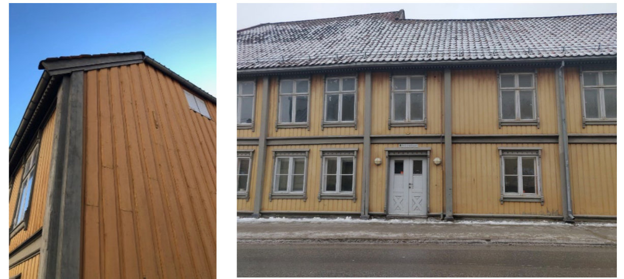
Figur 3.14-3.15. Trefasadene ut mot gateløpene har tydelig slitasje på malingen på panelet. Inn mot bakgården går panelet helt ned til terrenget og har store råteskade. Egenprodusert bilde.
