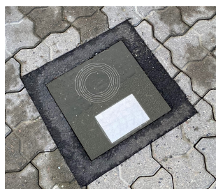
Figur 3.4.4: Bilde av grosh-plate i snøsmelteanlegget.
