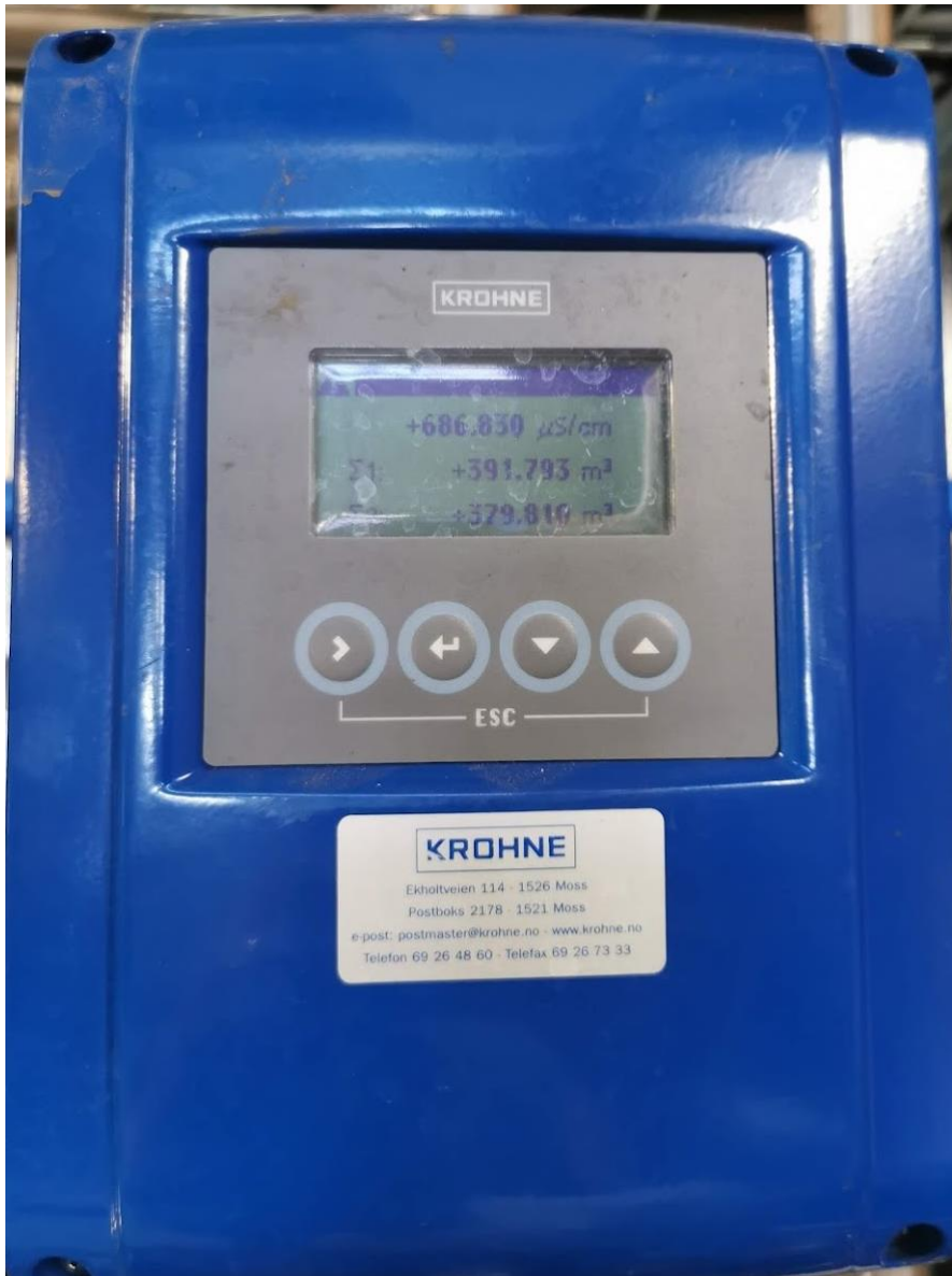
Figur 27: Bilde av digital gassmengdemåler, tatt av Andreas Stenseth 31 mars.
