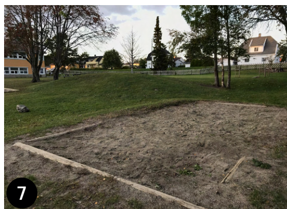
Bilde 79: Terreng har sunket i ett med terreng
