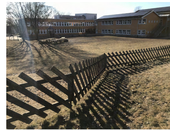
Bilde 11: Knekk ved grense mot nord ved Lervikveien
