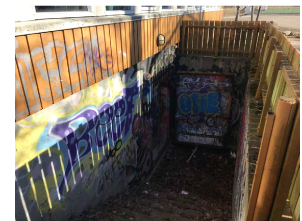
Bilde 130: Visuelt skjemmende trapp ned til nødutgang
