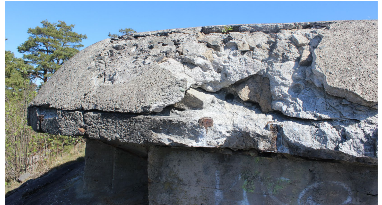
Fig 3.10: Fortet har enda spor etter kampen i 1940. Fulltreffere fra tysk artilleri er synlige i fortets struktur
