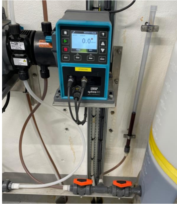
Figur 3.2 - Doseringspumpen for koagulant. Dette er en Qdos 30 universal, som leveres av Watson Marlow. Til høyre for doseringspumpa er 100 liters dunken som inneholder PIX-318.
