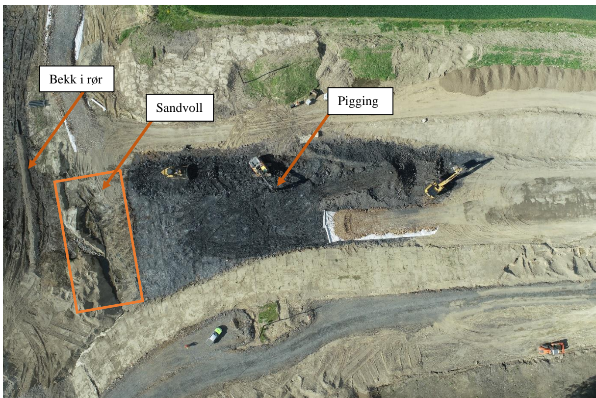
Figur 15: Bilde fra lokalitet U2 hvor det ble utført pigging av svartskifer i traue ved hjelp av gravemaskin utstyrt med pigg og bulldosere. For å beskytte bekken (V2) vest for uttaksområdet fra svartskiferpartikler ble det laget sandbanker og bekken ble lagt i rør.
