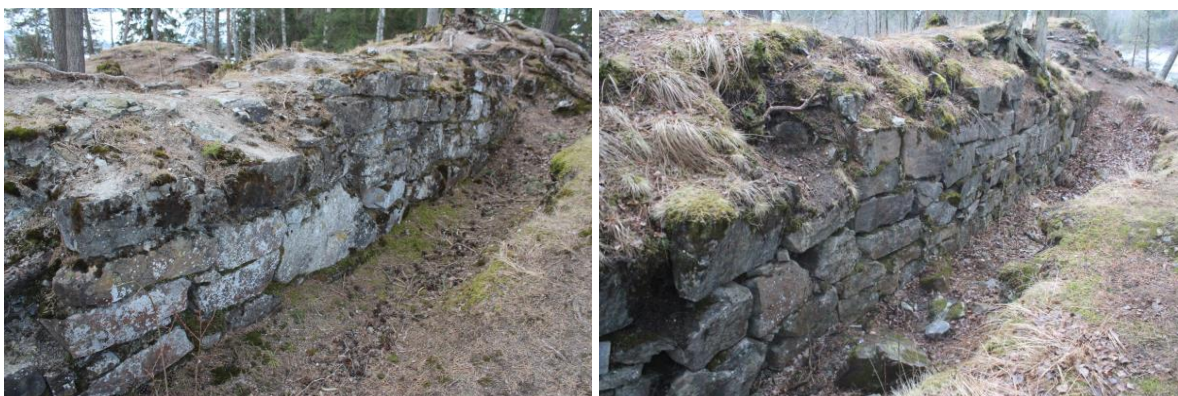
Figur 9: Visflate i vestmur og sørmur. Foto 25.04.2016 og 14.04.2016. Fra TILSTANDSVURDERING AV BORGRUINER: MJØSKASTELLET OG VALDISHOLM (Meyer & Haugen, 2020)
