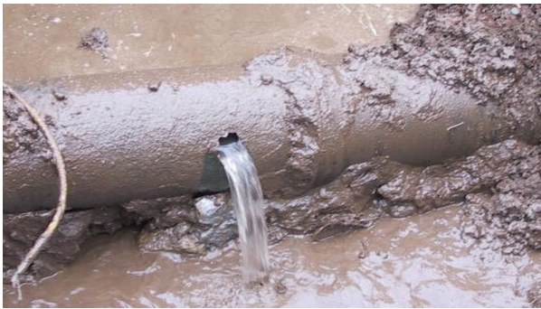
[1] Eksempelbilde av lekkasje på vannledning.
