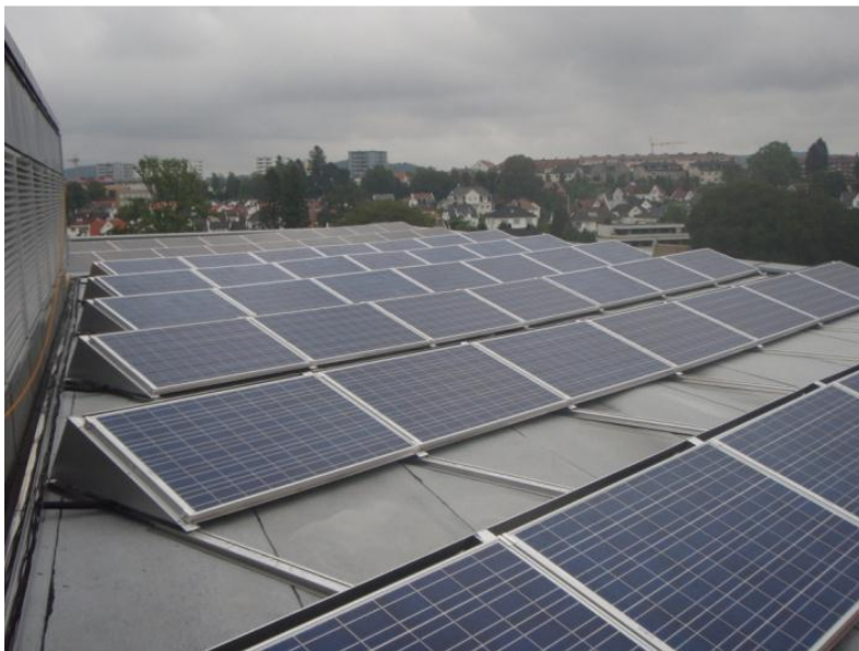
Figur 3.10 Solcelleanlegget på taket til Agder Energi sitt hovudkontor. Kjelde: (Enova 2013).
