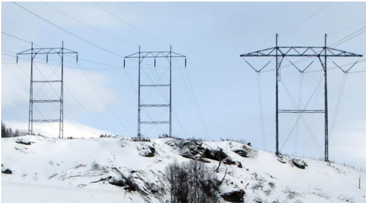
Figur 5: Viser to 320 kV bæremaster med tre faseliner, I-kjede isolator, innvendig bardunering og toppliner til venstre og en 420 kV bæremast med avstandholdere på faselinene og V-kjede isolatorer (foto: Statnett).
