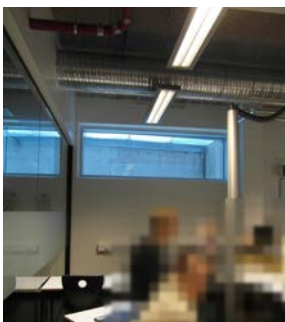
Figur 21 – Bildet, som er tatt ved besøk av skolene, viser utsyn ut til utvendig trapperom. Dette tilfredsstiller ikke denne undersøkelsens krav om utsyn og får dermed dårligst score.
