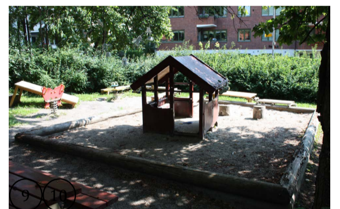
9 En stor og fin sandkasse ved småbarnsavdelingen. Kantene er i dårlig forfatning.
