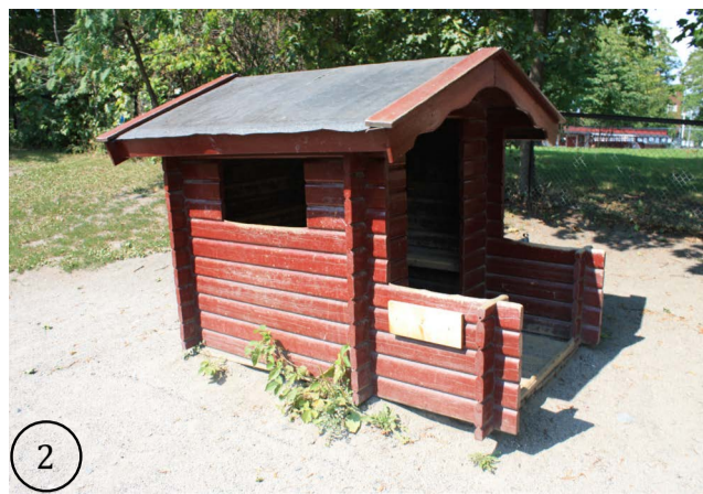
2 Lekehuset blir godt brukt og bærer preg av alder. Flere bord er dårlige og huset er i ferd med å falle fra hverandre.
