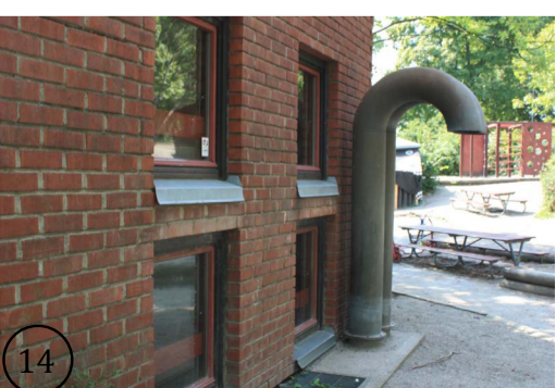
14 Lufterør fra tilflutsrommet i kjelleren av barnehagen. Rørene brukes som slagverk.
