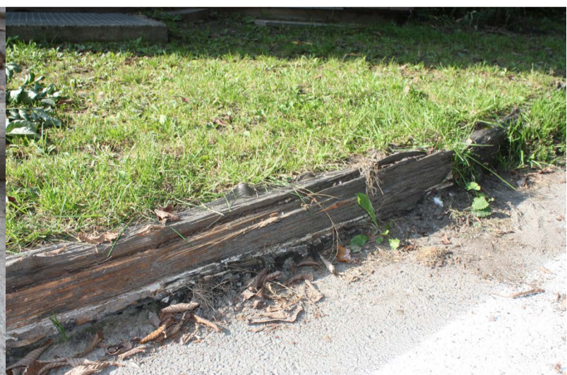
Dessverre er det dårlig vedlikehold flere slitte overfalter som dette.
