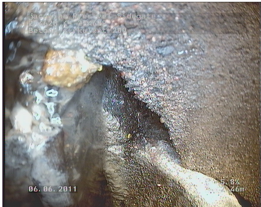
Foto: 274629_274628122320_06062011_B.JPG 2,45m, Forskjøvet skjot forskyvningen er mellom hele og 2 ganger rørtykkelsen eller skjøten er delvis åpen, fra 09 til 03 Kl., Tverrforsjøvet
