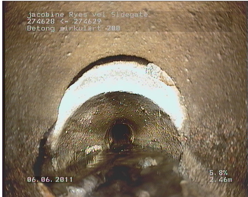
Foto: 274629_274628122300_06062011_A.JPG 2,45m, Forskjøvet skjot forskyvningen er mellom hele og 2 ganger rørtykkelsen eller skjøten er delvis åpen, fra 09 til 03 Kl., Tverrforsjøvet
