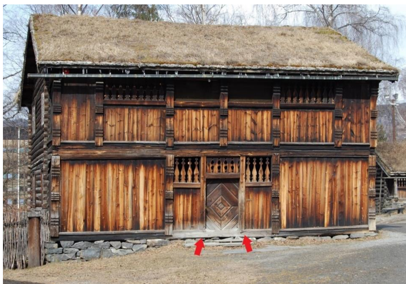
Figur 50 Råte har satt seg i bunnsvill, tilhørende søyler og dør på et eldre hus fra 1759. Foto: Maihaugen museum
