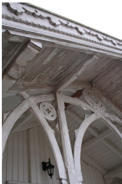
Fig. 63. Bildet viser at Kjeppestad er et viktig kulturminne, som bærer preg av manglende vedlikehold.
