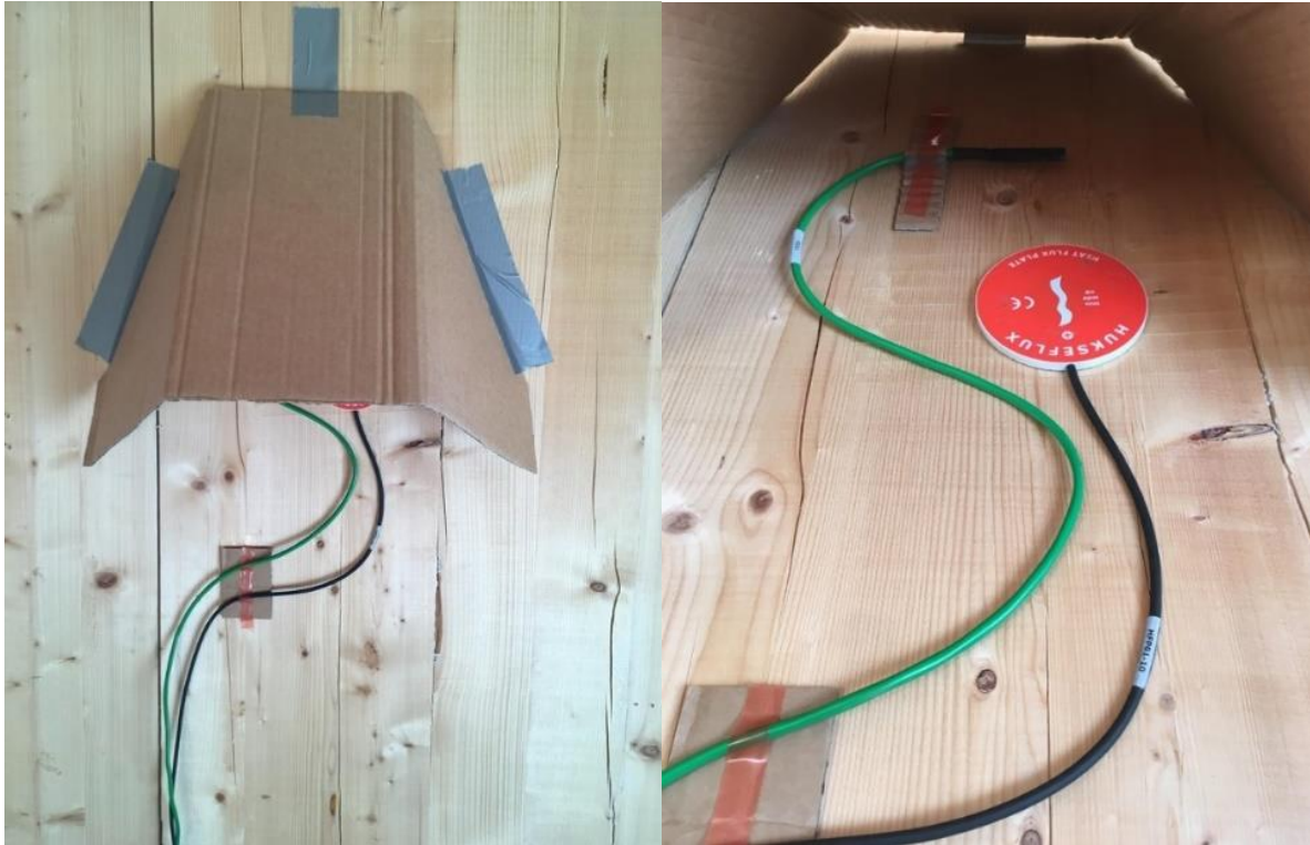
Figur 13: Bildet t.v. viser pappskjerm uten aluminiumsfolie. Det ble bemerket at denne skjermen kunne ta opp varme ved direkte stråling, og påvirke temperatur- og fluksmåleren. Bildet t.h. viser at mulighetene for mikroklima var til stedet da «sprekken» mellom veggen og pappskjermen var så liten (Jørgen Grue.)
