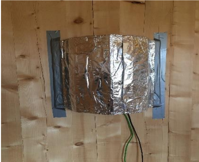
Figur 11: Bildet viser en aluminiumskledd pappskjerm som har til hensikt å skjerme temperatur- og varmekraftmåler for eventuell solstråling (Jørgen Grue).
