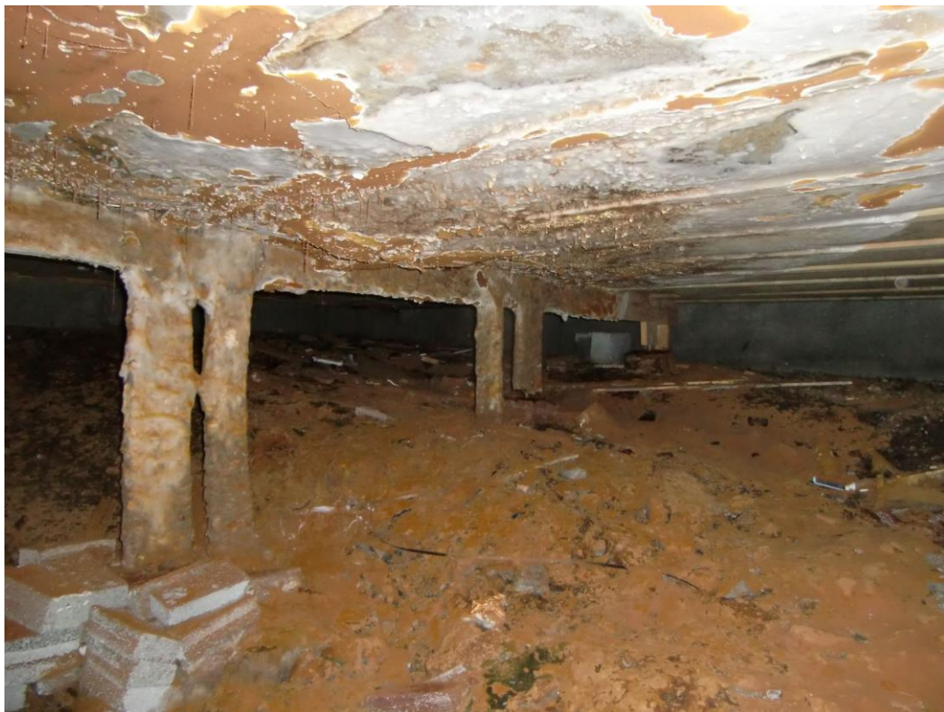
Figur 1.3: Uoppdaget fuktighet har resultert i at «ekte hussopp» har angrepet tak og pilarer [13].
