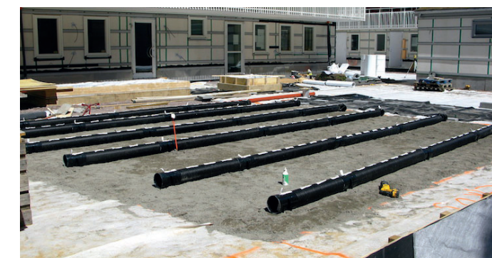
Foto 6.13 Savaq®-systemet lagt ut i et anlegg. Det hvite på toppen av rørene er vekene. (LOG utemiljø, u.å.)
