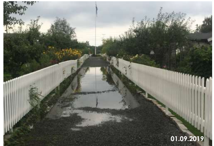
3. Oversvømmelse i gangvei mot fellesplassen, etter kraftig regn. (Foto: Line J. Barkved)
