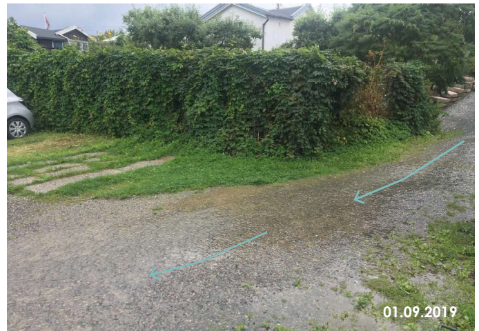
7. vannet strømmer ned på parkeringsplassen etter kraftig regnvær. (Foto: Line J. Barkved)
