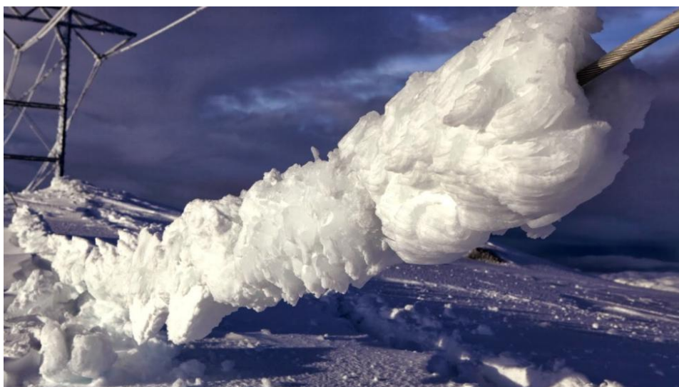
Figur 2.3: Skyis rundt en toppline i en 420-kV høyspentmast på Ålvikfjellet i 2013. Det hadde da vokst 68 kg is per meter, som førte til at topplinen kollapset. Foto: Ole Gustav Berg, Statnett
