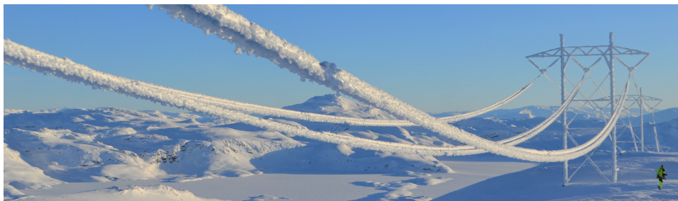
Figur 1.1: Ising på luftledninger på Ålvikfjellet. Foto: Statnett
