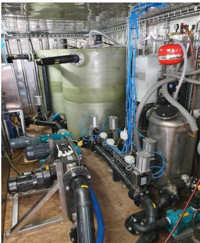
Bilde 2. Buffertankene, miksertank, pumper, ventiler, rør og annet utstyr inne i konteineren
