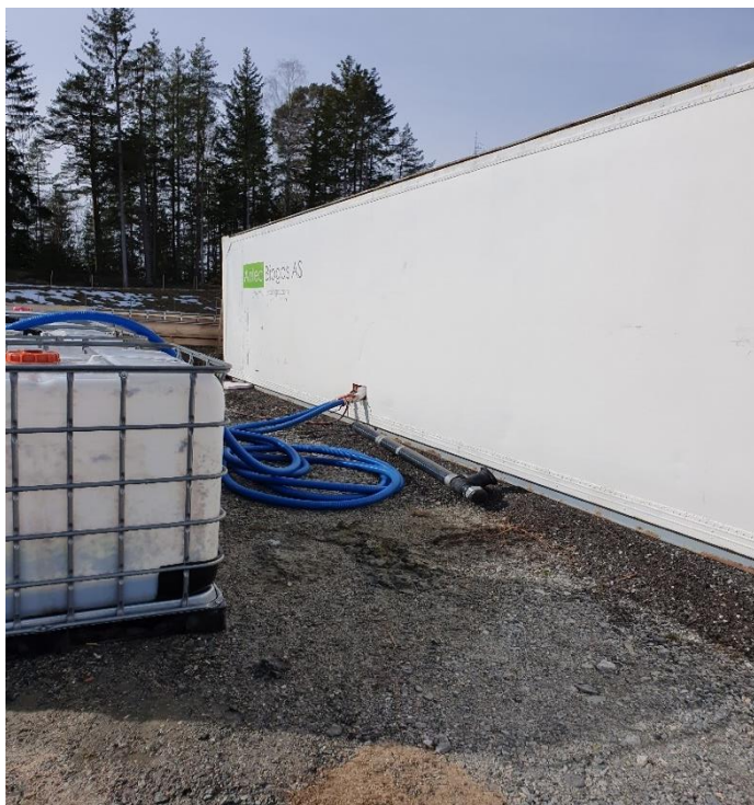
Bilde 1. Konteiner og lagringstankene på anleggsområdet. Biorest pumpes ut og substrat inn via rørledningen.
