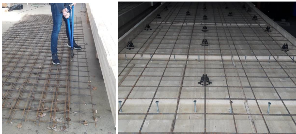
Figur 53: Bildene viser av kapping av armeringsnett tv og plassering av armeringen ved hjelp av støpestoler.
