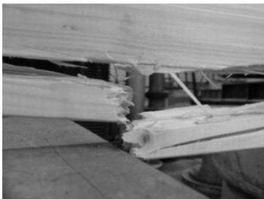
Figur 12: Typisk strekkbrudd for limtrebjelke uten forspenning.
