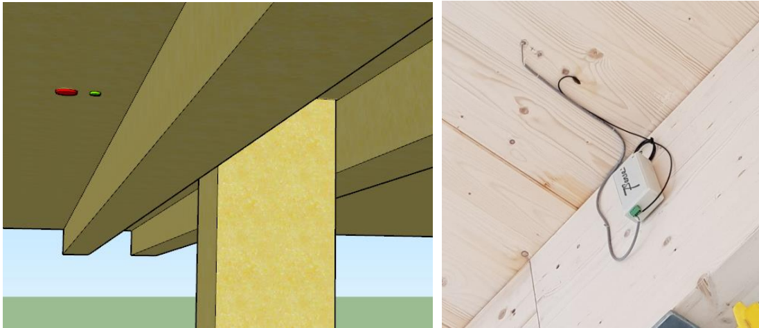
Figur 29 Målesensor i underkant av dekke
