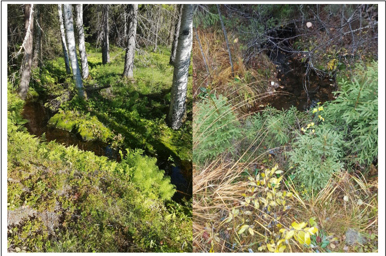
Figur 4-1 Elveløpet lengst mot nord bare et titalls meter fra anleggsområdet der de bygger ny veg. Bildet til venstre er fra 25.06.2019 mens bildet til høyre er fra 12.10.2019
