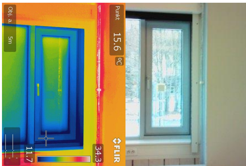
Figur 32 Termogram og fotografi av vinduene som ble brukt under måling tatt 12.03.19 på Sørhellinga. Temperaturen på punktet ved bunnkarmen er målt til å være 15,6 °C.
