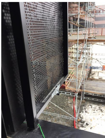
Figur 14 Bilde av hvordan temperaturlogger er montert på den faste solavskjermingen og ledning til utvendig termoelement er dratt mellom vinduene.
