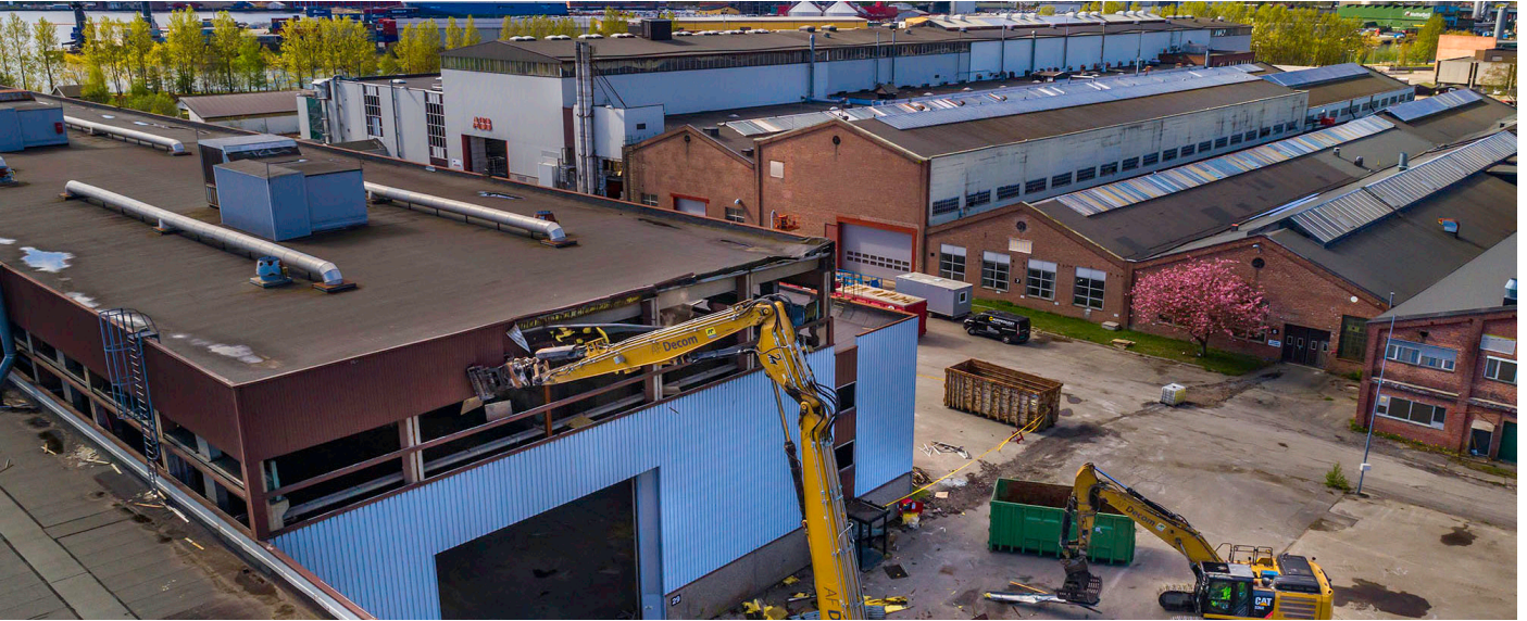
Figur 4.30: Riving av industribygg på Brakerøya for å få plass til nytt sykehus.
