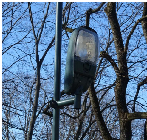
Benyttelse av tradisjonelle vei-armaturer, montert i vinkel, til å belyse muren rundt Botsfengselet.
