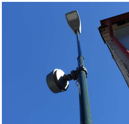
Lakkert stålmas med to armaturer for å belyse gateløp og gavlvegg
