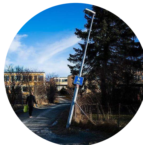
FIGUR 133: Skjeve master ødelegger for optisk føring og gir rotete anlegg med dårlig koherens. (Old, 2015)
