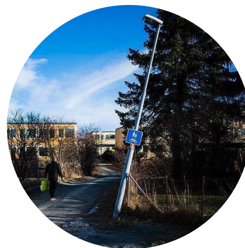
FIGUR 64: (Old, 2015) Skjeve master ødelegger for optisk føring og gir rotete anlegg med dårlig koherens.
