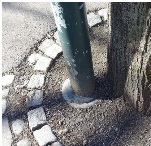
Lysmast med betongfundament helt inntill treet t.h. Dette vil bli problematisk innen få år.
