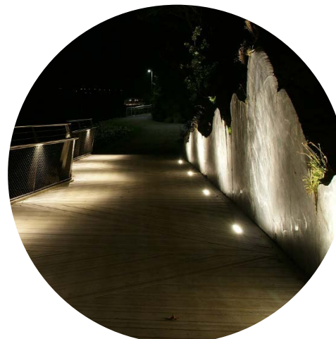
FIGUR 121: Nedfelt belysning sørger på lys på den vertikale flaten som avgrenser rommet ved Håhammeren (Fornes, u.å)
